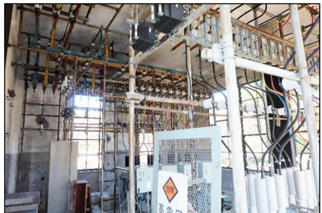
2階東側にある各施設への配電及び遮断装置
