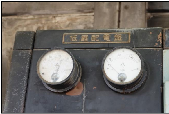
(左)「低圧配電盤」の表示プレート
