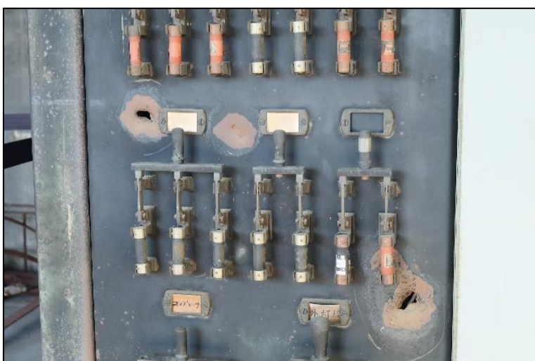
建設当初からの低圧配電盤 機銃掃射の痕がみられる。
